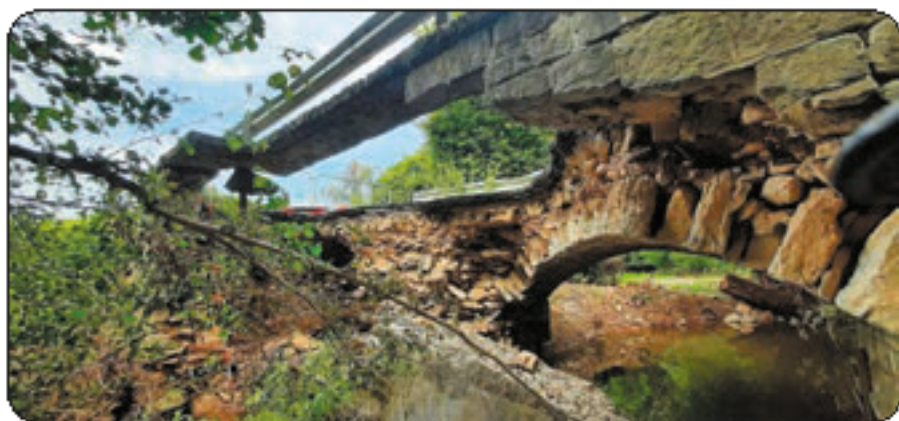
Les infrastructures routières ont particulièrement souffert, comme ici, entre Izier et Villers-Sainte-Gertrude.
