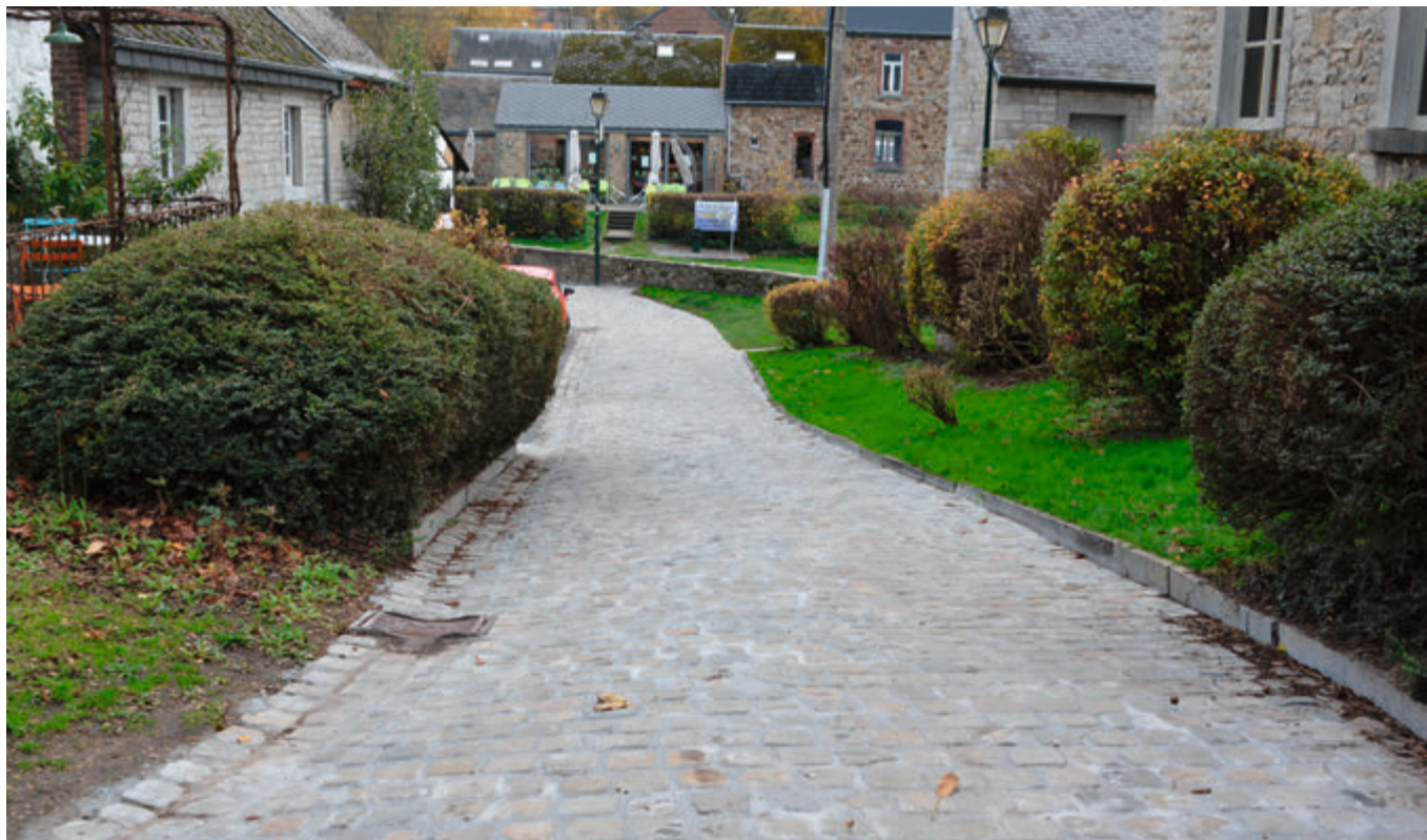
Les pavés de la ruelle qui descend vers la Maison des mégalithes ont été rejointoyés
